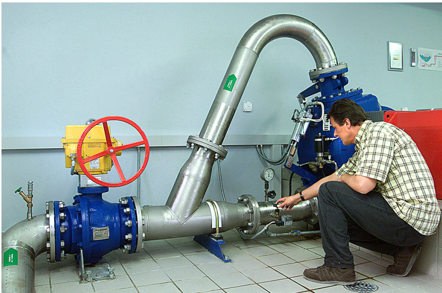
Bild 1: Realisiertes Trinkwasserkraftwerk (Quelle: Handbuch "Energie in der Wasserversorgung")
