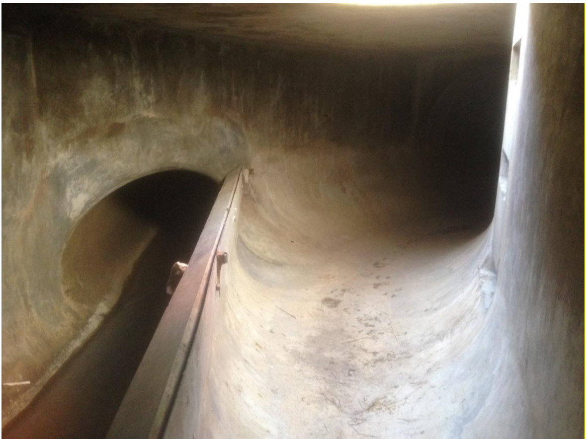
Abbildung 51: Regenüberlauf in Mischwasserkanalisation (links Richtung ARA, rechts: Entlastung in Bach)
