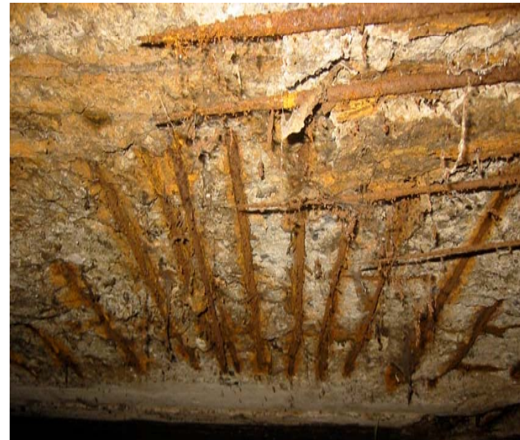
eingeschränkte Tragfähigkeit einer Decke
