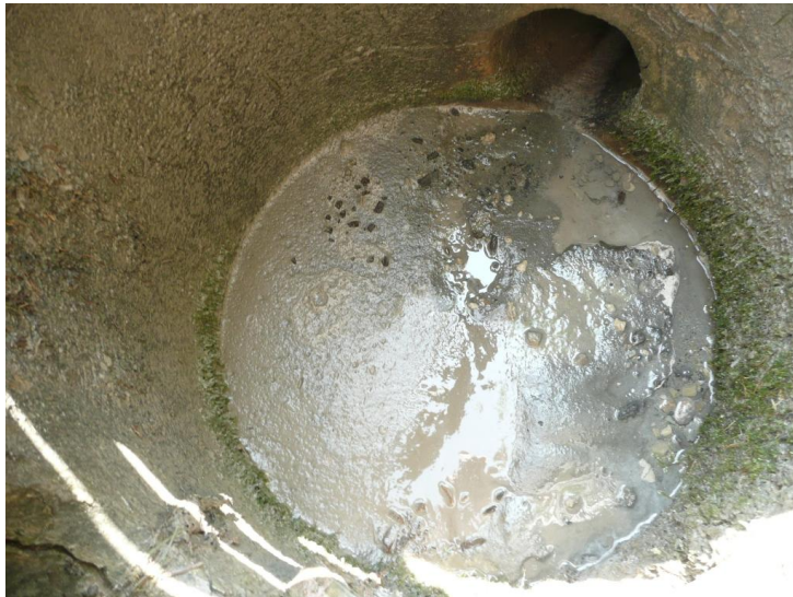
Mit Bohrschlamm verfüllter Schlammsammler (Teufen/AR, 2010)
