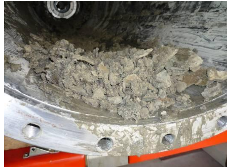
Ablagerungen in der Hochleistungs- zentrifuge der Kläranlage (Herisau/AR, 2010)
