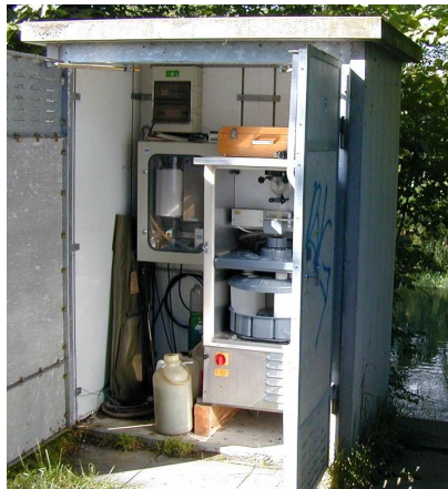
Abb. 2.1: Schöpfautomat bei der Hauptmessstelle «Furtbach bei Würenlos»
