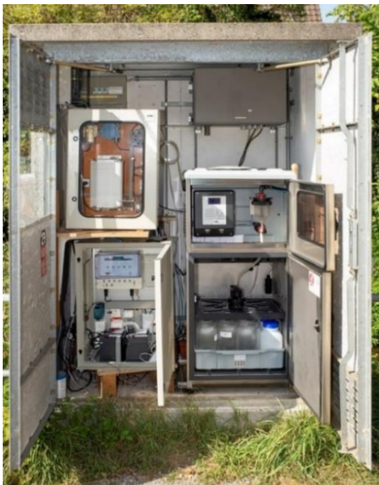
Abb. 2: Schöpfautomat bei der Hauptmessstelle «Furtbach bei Würenlos» (2019)
