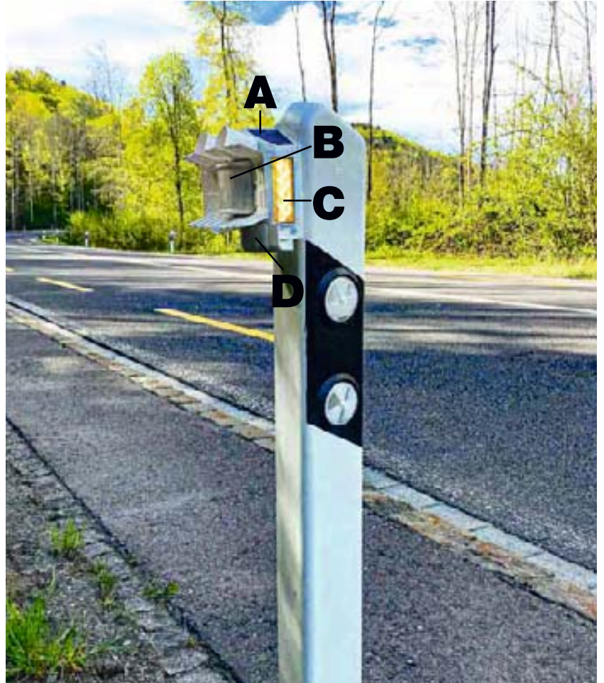
Die Module der Wildwarnanlage werden an die weissen Strassenleitpfosten mit einem maximalen Abstand von 50 Metern montiert. Die Hauptbestandteile eines Moduls sind: A) Solarmodul, B) Erkennungssensor, C) LED-Warnsignal und D) Akkufach und Speicherung der Daten. Quelle: Forschungsgruppe Wildtiermanagement, ZHAW
