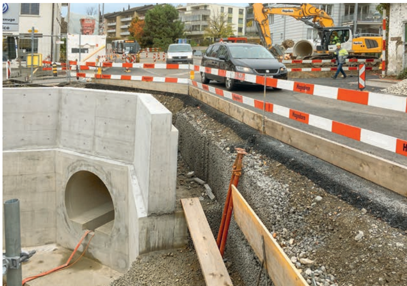
Gemeinden können die Verbindung unterbrochener Lebensräume ebenfalls fördern. Im Foto: Bachdurchlass mit kleintiergängigen Banketten, Aufdorfstrasse, Männedorf. Quelle: I. Flynn
