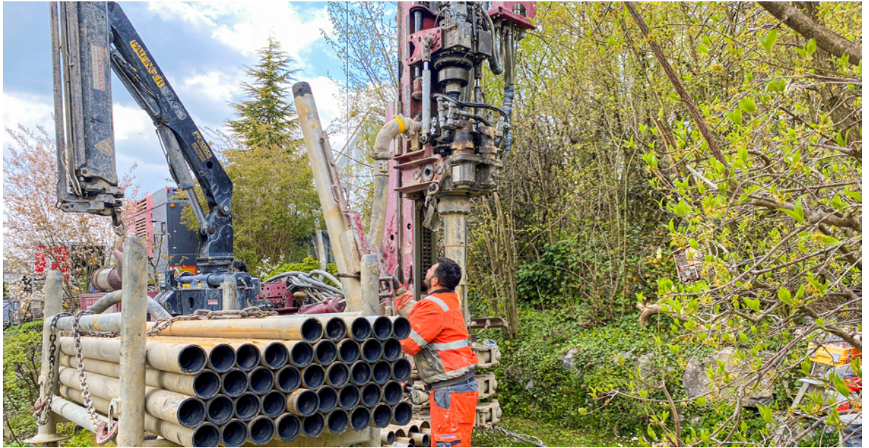
Erdwärmesonden-Wärmepumpen nutzen klimafreundliche Energie aus dem Untergrund. Im Bild: Installation zur Bohrung der 200 Meter tiefen Sonde. Quelle: I. Flynn
