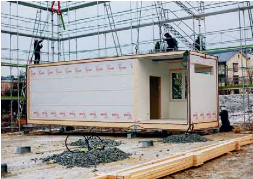
Die Standardmodule wurden vorgefertigt und vor Ort innert weniger Tage auf- und ausgebaut. Quelle: HBA
