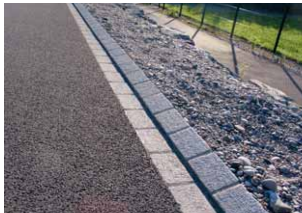
Abgeschrägte Randsteine ermöglichen den Tieren, die Strasse rechtzeitig zu verlassen. Quelle: Simon Gaus
