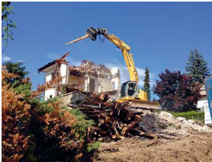
Geordneter Rückbau von Altbauten. Das Material wird sortiert und weitmöglichst rezykliert. Quelle: AWEL, Simon Schwarzenbach
