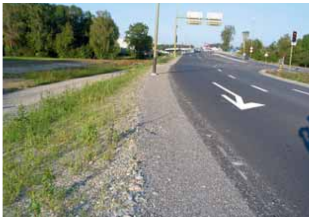
Entwässerung über die Strassenschulter vermeidet Probleme mit Randabschlüssen und Schachteinläufen. Quelle: Simon Gaus
