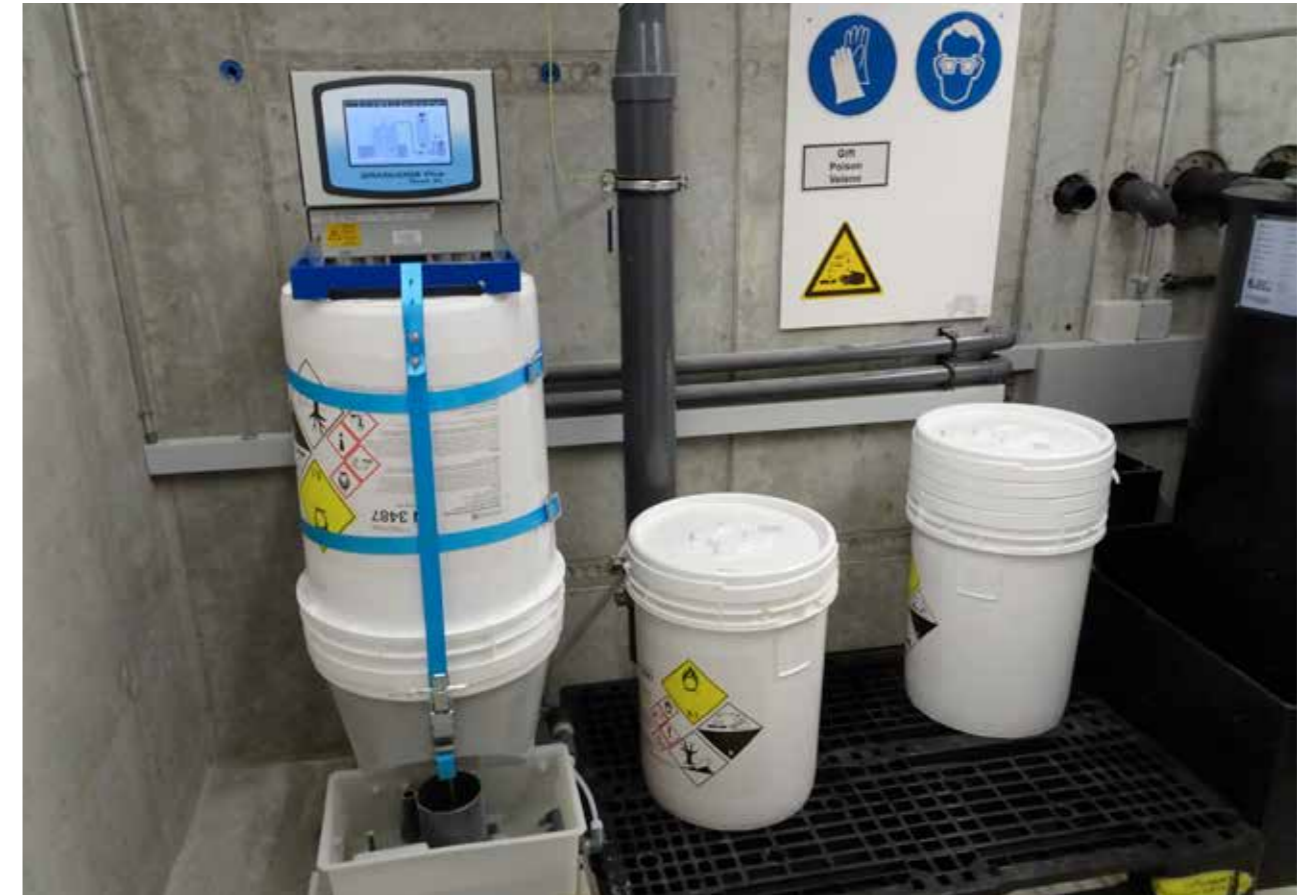
Foto 1: Dosierstation mit Chlorgranulat (Calciumhypochlorit)
