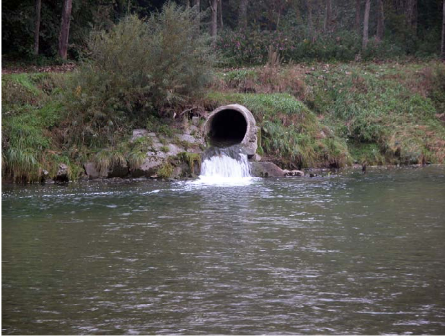
Abbildung 26: Der Mederbach mündet derzeit über eine Verrohrung und einen Absturz in die Thur (Aufnahme vom 19.09.08). Einzig bei erhöhten Thurabflüssen können Fische aus der Thur in den Mederbach einwandern.
