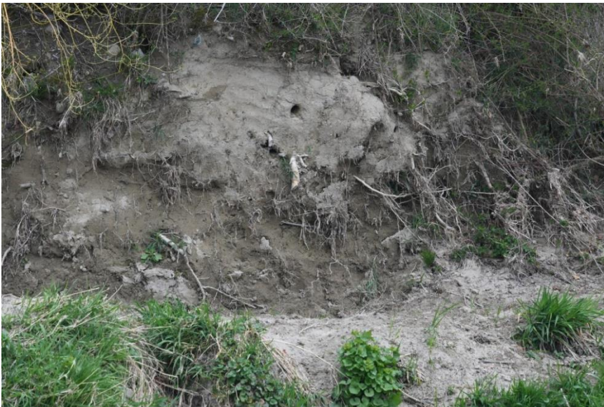
Abb. 7: In den Grueben wurde die zerfallene Wand am 18. März mit dem Bagger wieder instand gestellt. Dabei wurde der untere Teil der Wand abgegraben. Die Höhle stammt aus früheren Jahren und blieb erhalten.
