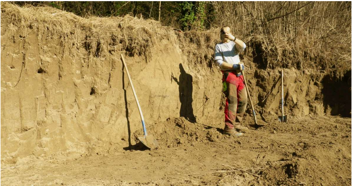
Abb. 3: Chli Au vorher-nachher: Durch das AWEL wurde am 25.02.2015 eine Wand in Handarbeit erstellt (Bild unten: AWEL). Durch das Hochwasser von Anfang März wurde der untere Teil der Wand wieder stark eingesandet.
