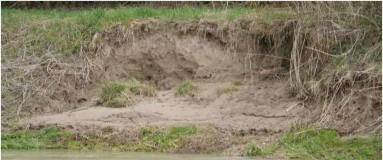
Abb. 31: Wenige Tage, nachdem die Steilwand in der Chli Au errichtet wurde, wurde sie durch ein 500 m 3 /s-Hochwasser wieder eingesandet. Danach wurde nur eine kleine Partie behelfsmässig wiederhergestellt (03.04.2015).
