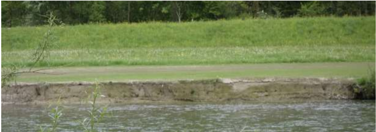
Abb. 40: Die Erosionskante unterhalb des Feldistegs ist hochgradig hochwassergefährdet (06.05.2014; Foto: Fide Meyer).
