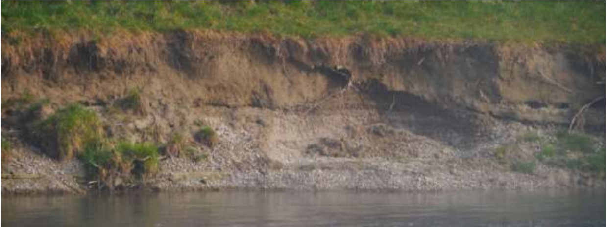
Abb. 4: In der Oberen Tüfenau wurden die Auflandungen unterhalb einer Abrisskante durch das AWEL abgetragen.
