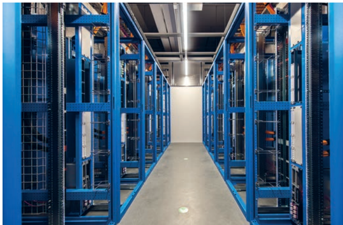
Rechenzentren sind grosse Stromverbraucher.
