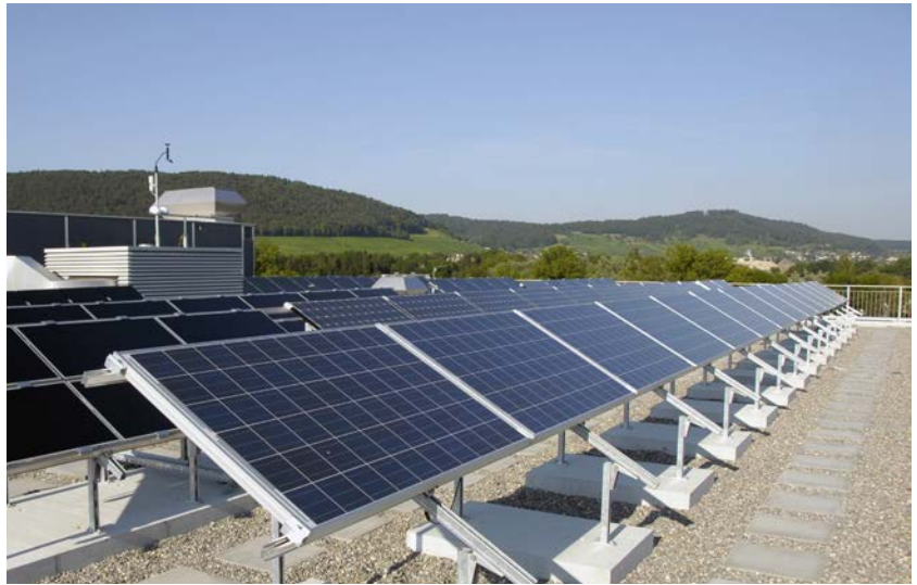
Photovoltaiktestanlage auf dem Dach der Elektrizitätswerke des Kantons Zürich in Dietikon
