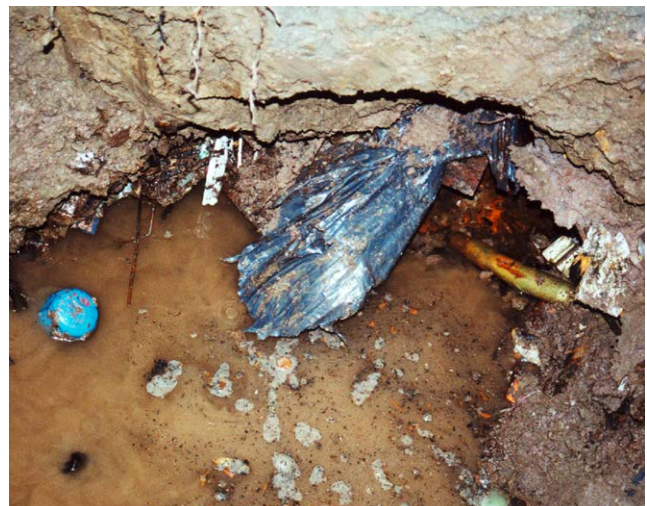
Auffüllmaterial mit Hauskehricht
