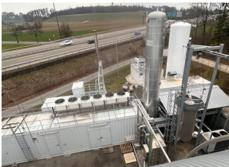
Foto 8: Energieproduktion: Gas-aufbereitung für die Einspeisung ins Erdgasnetz in Winterthur: Die Einspeisung von aufbereitetem Biogas ins Erdgasnetz wird nur von «grossen» Anlagen praktiziert. In zusätzlich erbauten kleineren Anlagen wird mehrheitlich Strom produziert.
