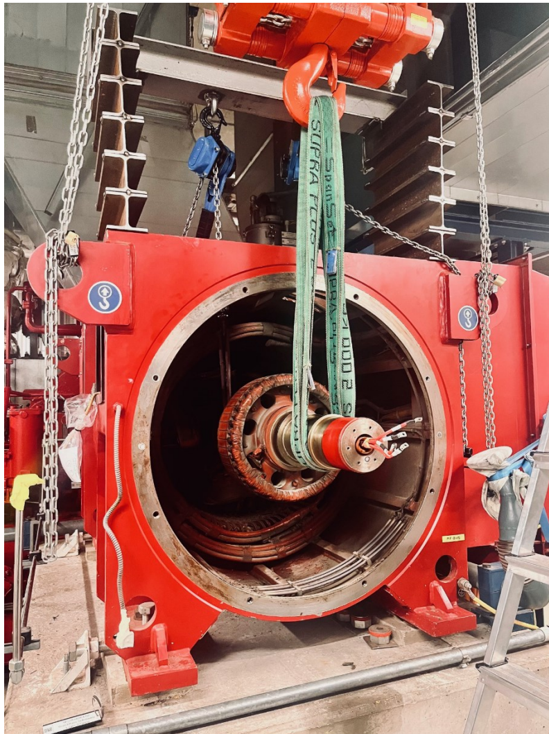
Abbildung 9: Im August 2023 erlitt die Erregerwicklung des Generators einen Kurzschluss. Eine Wicklung musste komplett ersetzt werden. Nach lediglich 10 Tagen Stillstand konnten wir wieder Strom produzieren. Der elektrische Eigenversorgungsgrad 2023 der KSV beträgt trotz allem 104 %.
