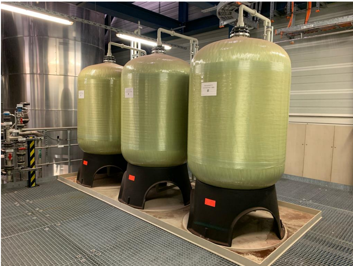
Abbildung 9: Abwasser-Behandlungs-Anlage kurz ABA.
