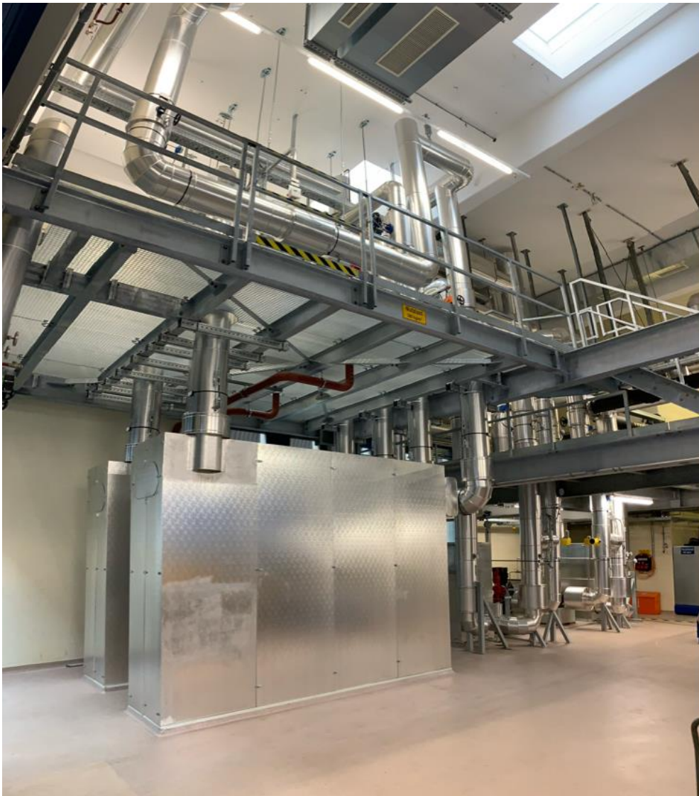
Abbildung 2: ewz Wärmeverbund Altstetten-Höngg. Platten-Wärmetauscher-Anlage im EG der EZA und die dazu nötigen Versorgungsleitungen und Regelventile darüber liegend.
