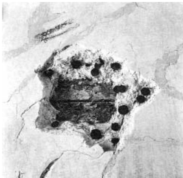
Predigerkirche. Verankerung des Stuckes an der Holz-Tonnendecke mit grossköpfigen Nägeln. Rund um die blossgelegte Stelle alt ausgeflickte Risse.
