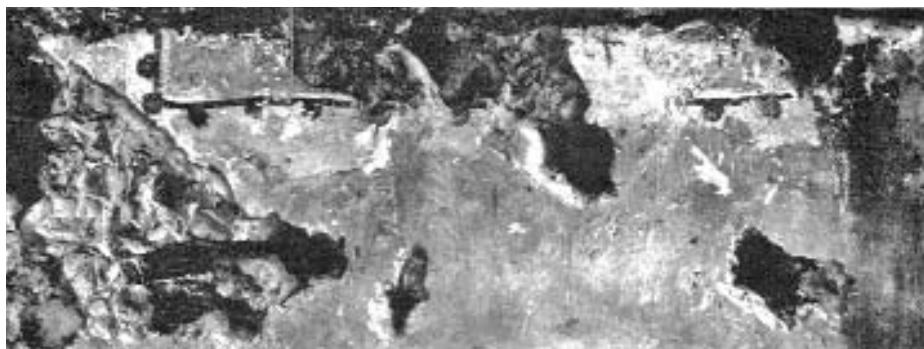
Bassersdorf. Reformierte Kirche. Süd-mauer des Kirchenschiffes mit Farbresten gotischer Bordürenmalerei in Grau und Schwarz; darüber mittleres Fenster.
