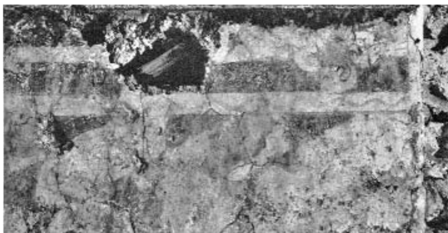
Bassersdorf. Reformierte Kirche. Süd-mauer des Kirchenschiffes mit Resten gotischer Sockelmalerei in Weiss und Grau; Wellenbandrest rechts oben orange. Darüber Ostfenster, rechts ehemaliges Südportal. 1:20.
