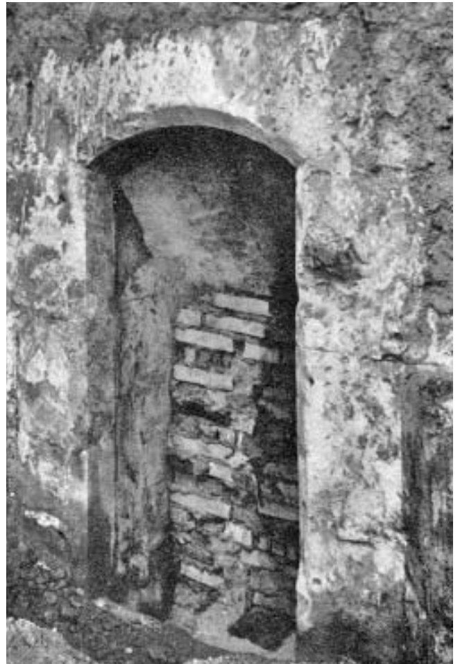
Elgg, Reformierte Kirche. Südlicher Eingang zur Krypta, nach der Freilegung im März 1964.
