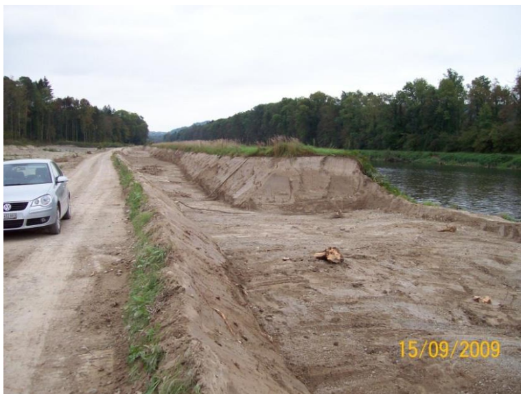
Materialabtrag vom Schutzdamm bei M3
