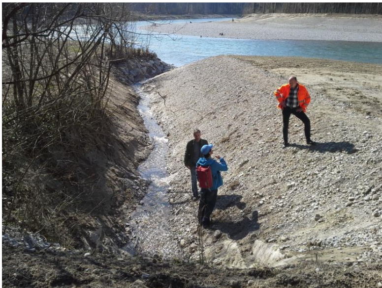
Frisch umgestaltete Schüepbachmündung mit (v.l.n.r.) Pascal Sieber (AWEL), Marc Autenrieth (AWEL), Dominik Krebs (Bauleiter)
