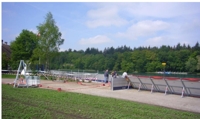
Mobile Hochwasserschutzzelemente: Insgesamt können 250 Laufmeter Dammbalken (links) und 500 Laufmeter Bocksystem aufgestellt werden. Grund- und Meteorwasser werden aus vorbereiteten Brunnen in den Rhein gepumpt
