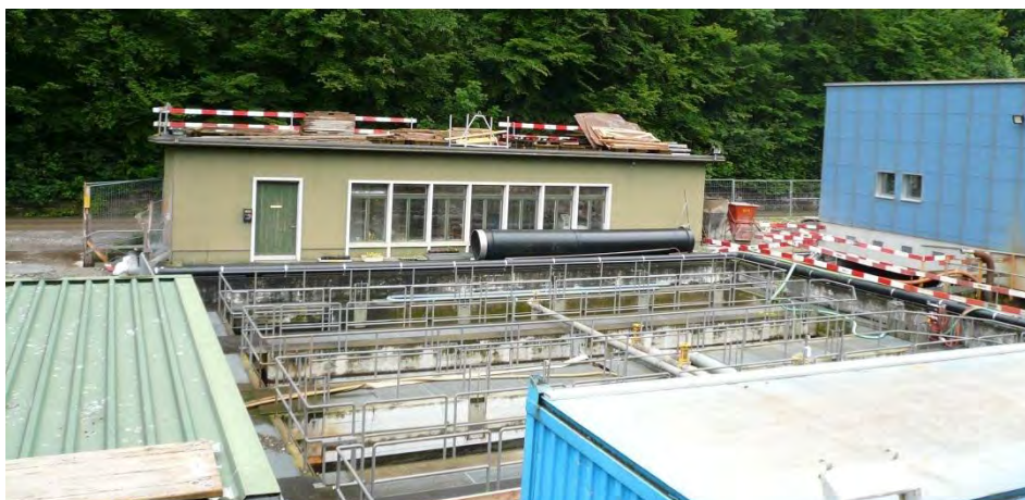
Abbildung 23: Betriebsgebäude und Auffangbecken für Fernwärme
