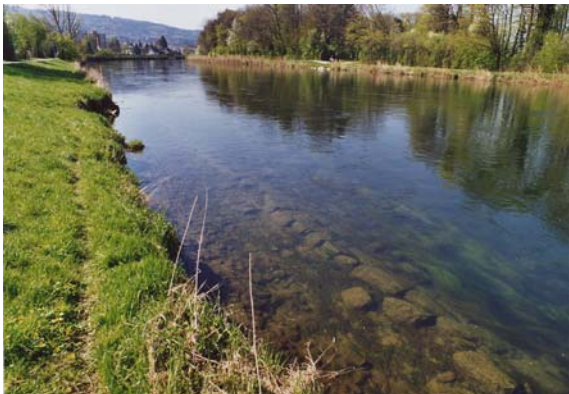
Uferschutz und Ufer erodiert (Böschungsfuss-sicherung noch sichtbar).
