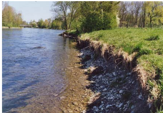
Uferschutz vollständig erodiert.
