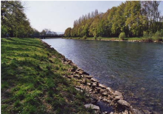
Oberer Bereich der Ufersicherung erodiert.
