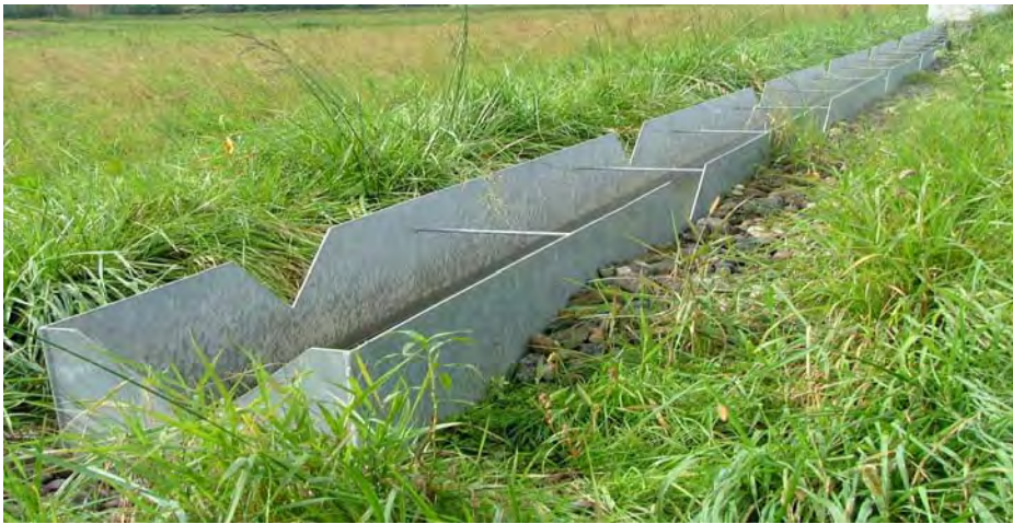
Retentionsfilterbecken Rorzelt, in Betrieb. Im Gelände sind nur noch die schmalen Verteilrinnen für das Regenwasser erkennbar.
