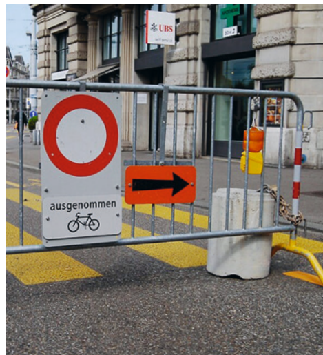
Sowohl der Radstreifen wie auch das Trottoir bleiben trotz Baustelle frei (Löwenstrasse Zürich).
