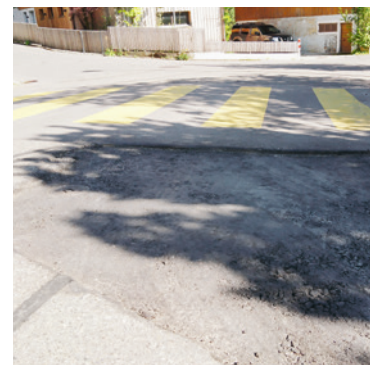
Der Deckbelag ist noch nicht eingebaut, im Gefälle droht Sturzgefahr (Bruggenstrasse Volketswil).
