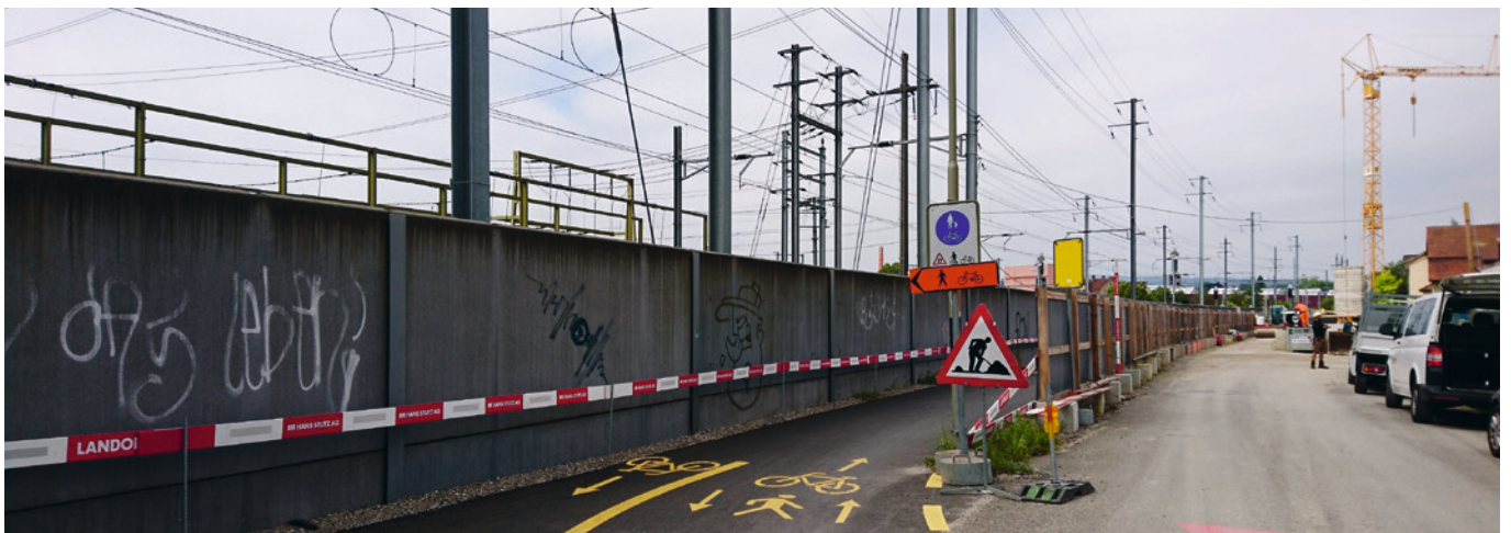
Komplexe Baustellen benötigen eine phasengerechte, vorausschauende Planung aller Beteiligten, damit für alle Verkehrsteilnehmenden gute Lösungen gefunden werden können (Hegistrasse Winterthur).
