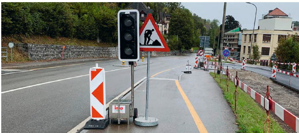
Signale und Lichtsignalanlagen behindern den Veloverkehr auf dem Rad- und Fussweg (Winterthurerstrasse Kempththal).
