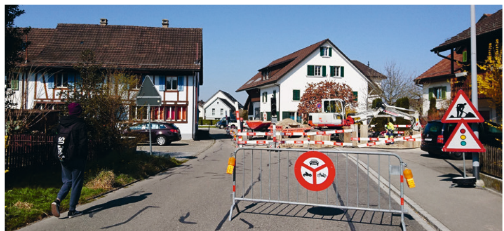
Die Baustelle wird gezielt für den Veloverkehr offen gehalten. Optimal wäre ein Signal SSV 2.13, damit auch schnelle E-Bikes den Motor nicht ausschalten müssen (Stationsstrasse Nänikon).
