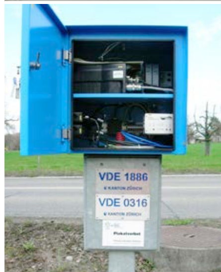
MIV- und Velozählstelle in Greifensee. Die eingebauten Schlaufen erfassen alle Velofahrenden auf dem Radweg. Die Technik für die Zählung der Velos wurde in die bestehenden MIV-Zählkästen integriert.
