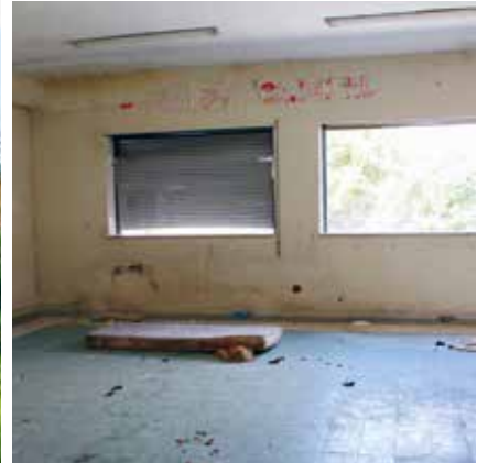
Das Primarschulhaus San Francesco wurde nach wenigen Jahren verlassen. Zum Bau war radioaktive Schlacke aus der Metallindustrie verwendet worden.
